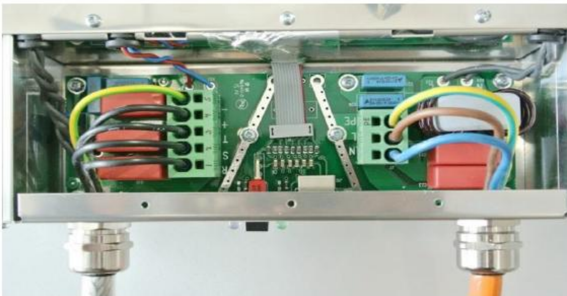
Abbildung 16 - Kabel in der Kontrolleinheit angeschlossen
